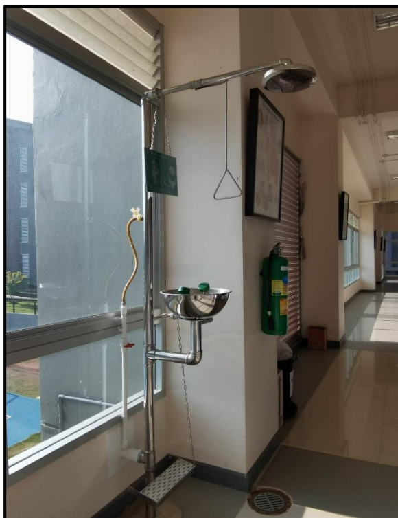
รูปที่ 3 อ่างล้างตา และที่ล้างตัวฉุกเฉิน
